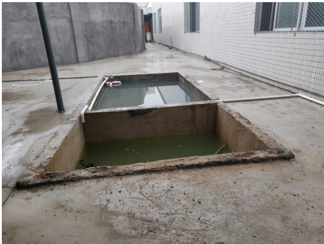
污水处理设施
