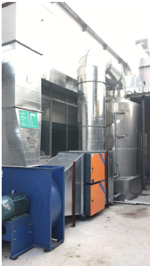
喷漆废气处理设施
