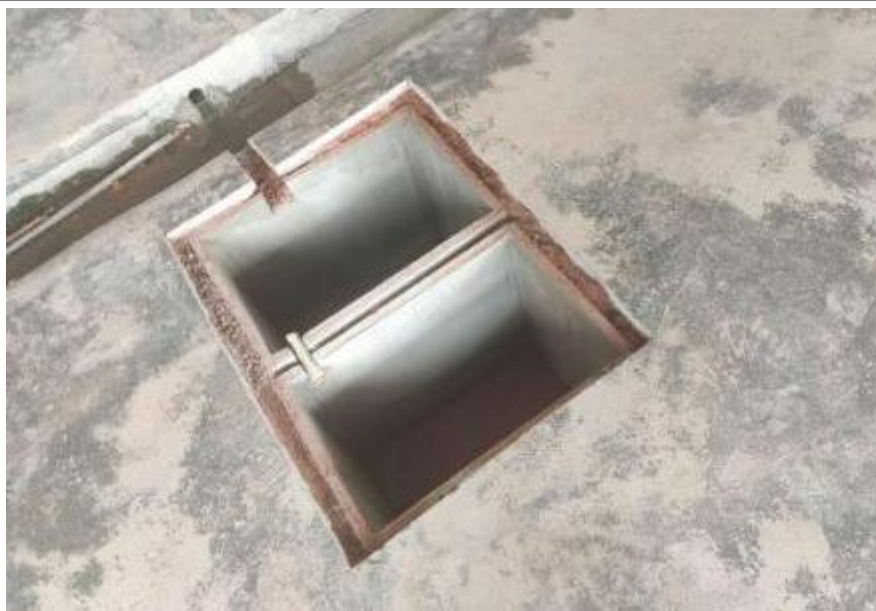
污水处理设施
